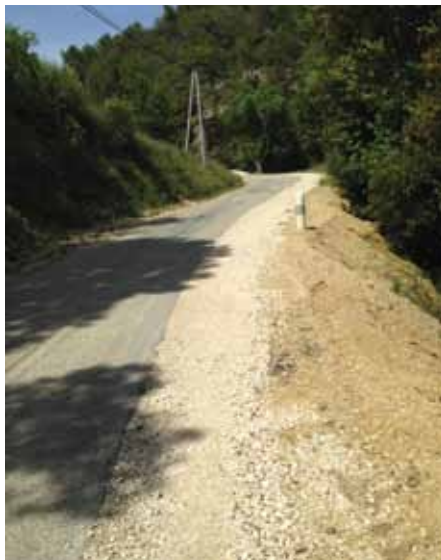
Passage en souterrain des réseaux BT et télécoms. Le poteau télécom que l'on aperçoit a aujourd'hui disparu
